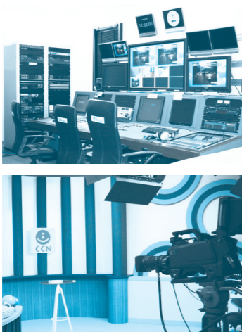
ハイビジョンに対応した、スタジオ設備と副調整室（サブコントロールルーム）
