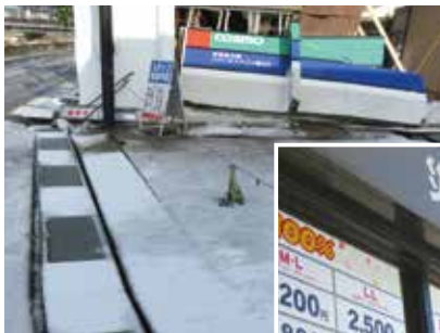
側溝隙間（防火塀転倒）
