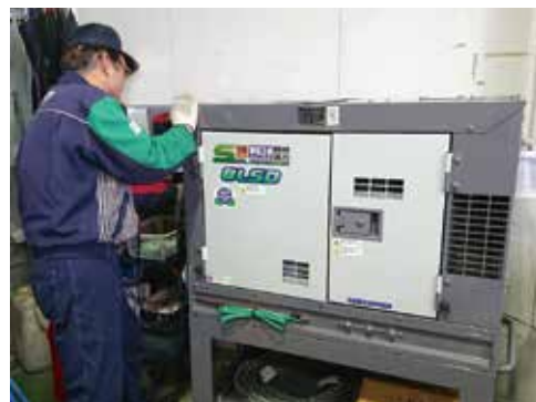
防災訓練風景（発電機稼働）
